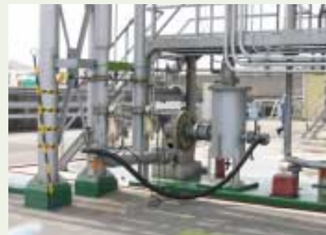
ローリー内のベーパーを回収する装置
