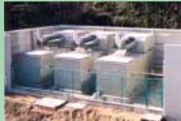
自家発電システムの外観
